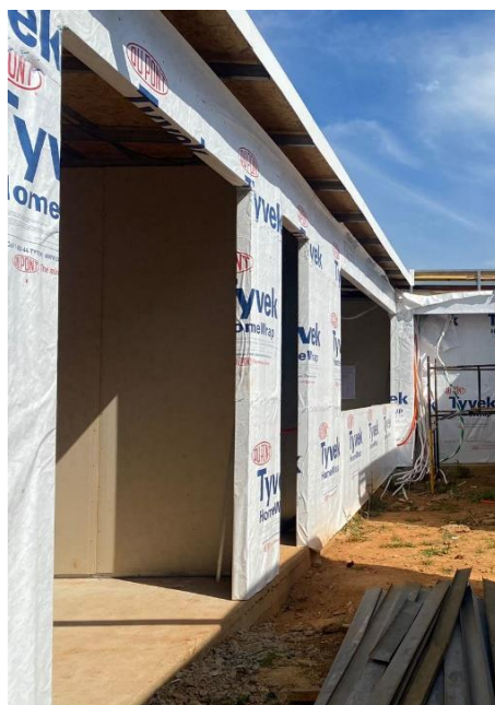
Figura 20 – Barreira resistente à água e permeável ao vapor d'água instalada na face externa dos painéis metálicos
