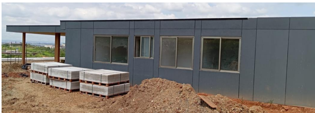
(c) Fachada da casa em construção na cidade de Porto Feliz, SP
