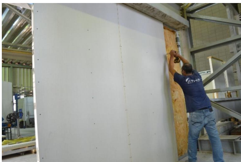
Figura 27 – Fixação das chapas de gesso para drywall após a instalação da lã de vidro no interior da parede
