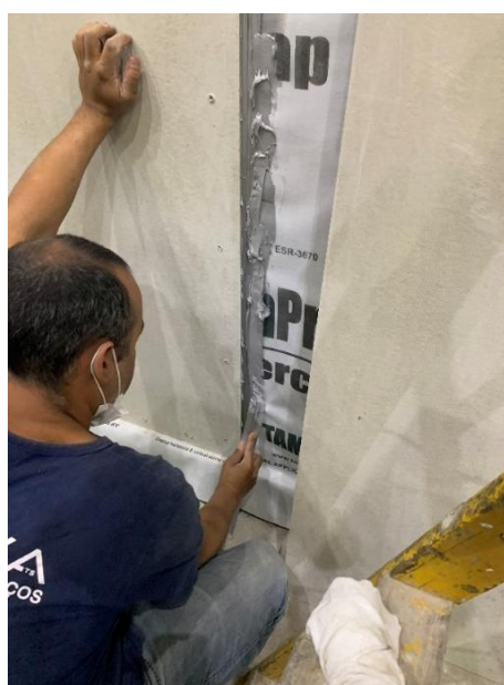
Figura 22 – Aplicação do selante para fixação do perfil de alumínio entre as chapas cimentícias
